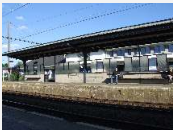
Sur les quais, le confort d'attente est médiocre (pas de coupe-vent et vitrages brisés)
